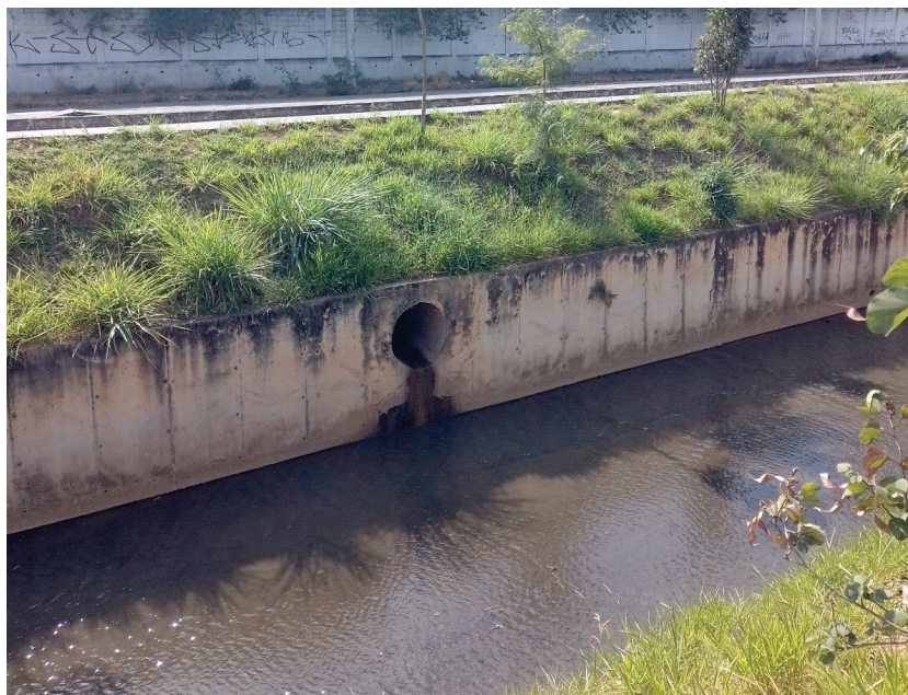
Figura 10 - Manilha lançando esgoto no córrego.
