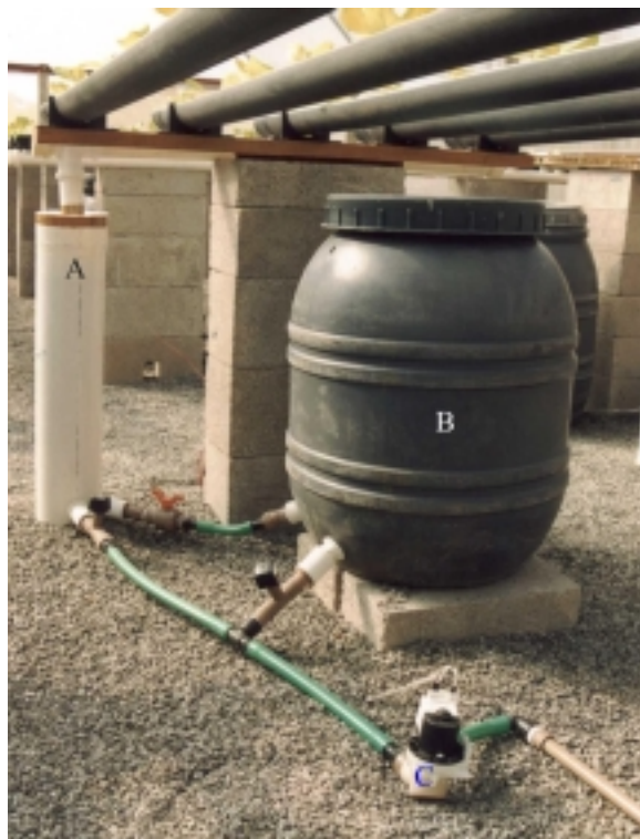
Figura 1.9 – Vista do sistema hidráulico das bancadas de cultivo. Tanque de medição (A), tanque de armazenamento da solução nutritiva (B), bomba (C).
