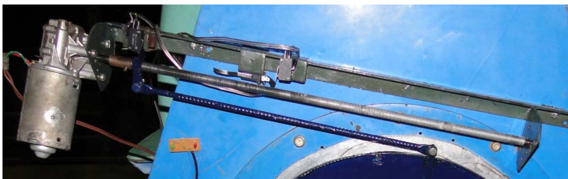
Figura 12 - Sensores de posição instalados à estrutura eletromecânica.
