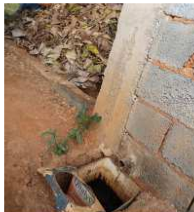
Estrutura de recuperação do chorume (Viçosa)
