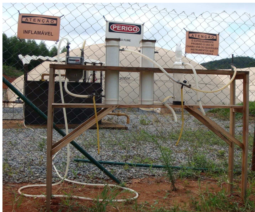
Figura 02. Vista geral do protótipo do sistema de purificação
