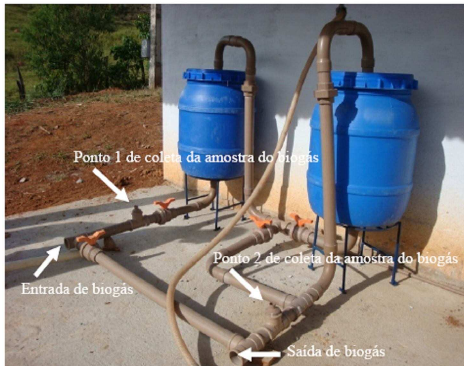
Figura 03. Vista geral do sistema de purificação – Longa duração
