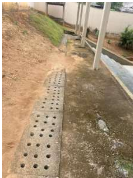
Fotografia 06: Local de Instalação da Mini ETA (Imagem 03)
