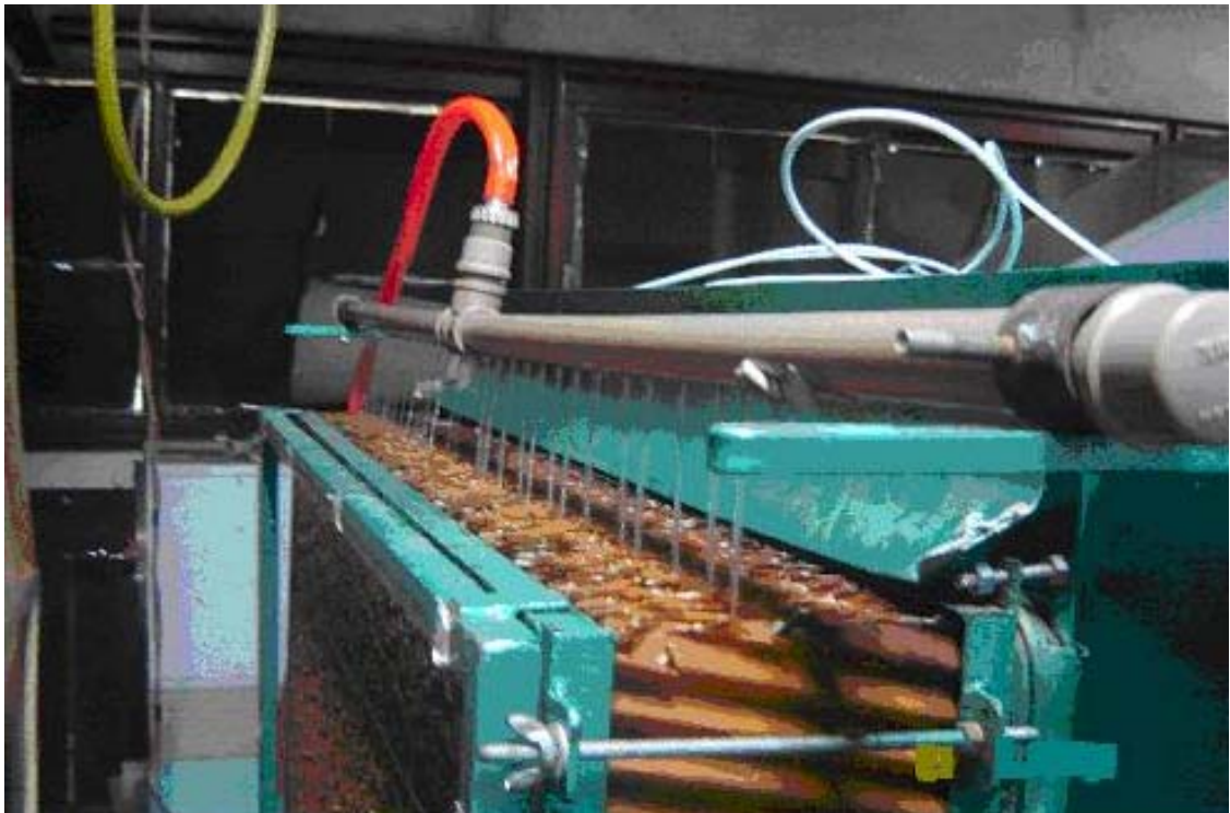
Figura 20 – Sistema de molhamento dos painéis evaporativos.
