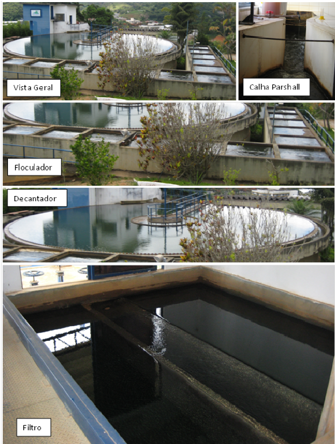
Figura 9 Vista geral e das unidades de mistura rápida, floculação, decantação e filtração da ETA SAAE I
