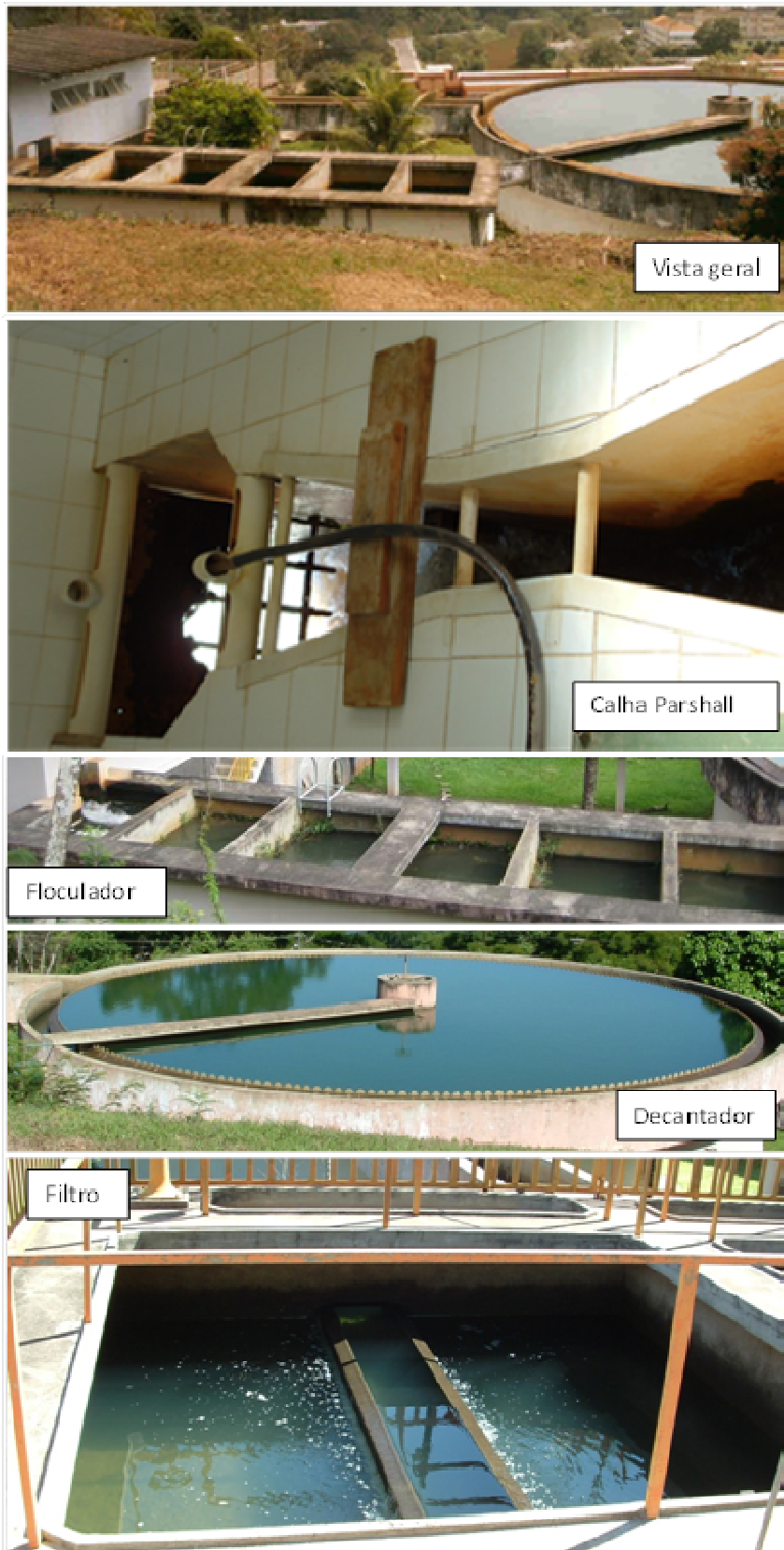
Figura 8 Vista geral e das unidades de mistura rápida, floculação, decantação e filtração da ETA UFV
