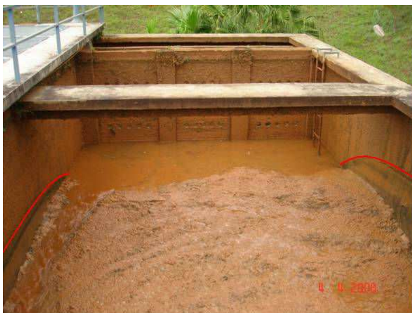
Figura 61 Acúmulo excessivo de lodo no decantador da ETA SAAE II (a marca em vermelho mostra o nível atingido pelo lodo)
