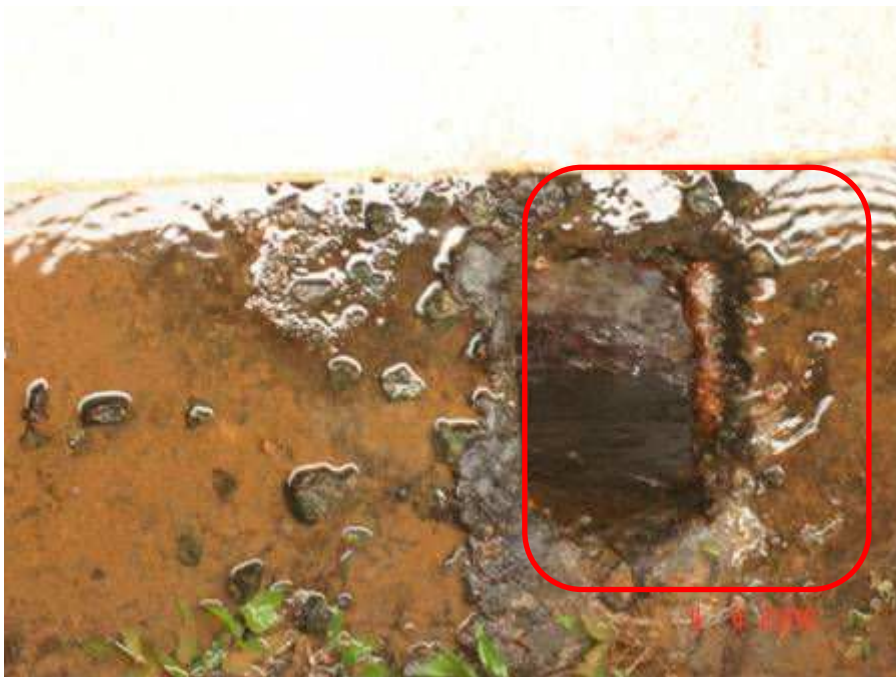
Figura 25 Detalhe de uma das passagens da canaleta de distribuição de água floculada para o decantador 1, ETA SAAE II
