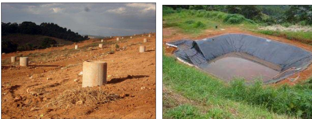
Figura 55. Rede de dreno de gases e lagoa facultativa do Aterro Sanitário de Viçosa
