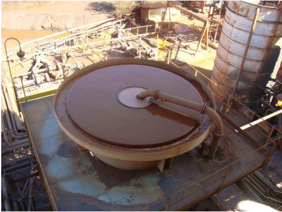
Figura 12 - Vista superior do cone desaguador do rejeito da separação magnética.
