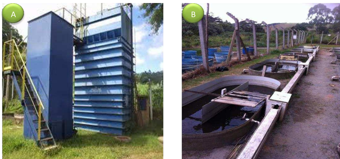
Figura 7. (A) Reator anaeróbio UASB que precede (B) as LATs na Unidade Experimental Integrada de Tratamento de Esgotos e Utilização de Efluentes da Violeira.
