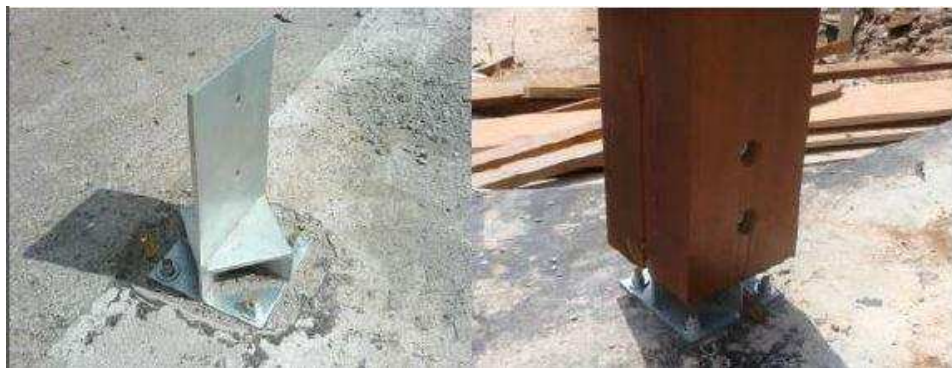
Figura 57 – Encontro da base de concreto com o pilar de madeira Fonte: Meirelles (2010) apud Dias, Alan (2008).
