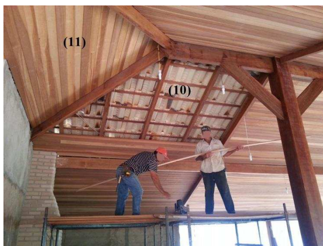
Figura 47 – Acabamento interno num forro do subsistema de vedação horizontal (cobertura-forro). Fonte: Autor.
