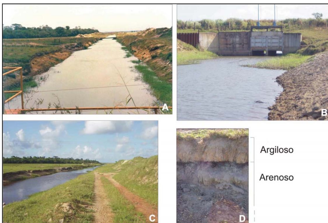
Figura 70. Travessia da estrada municipal Bebedouro-Regência: galerias com concreto pré-moldado com stop-logs. Veja Quadro 28.
