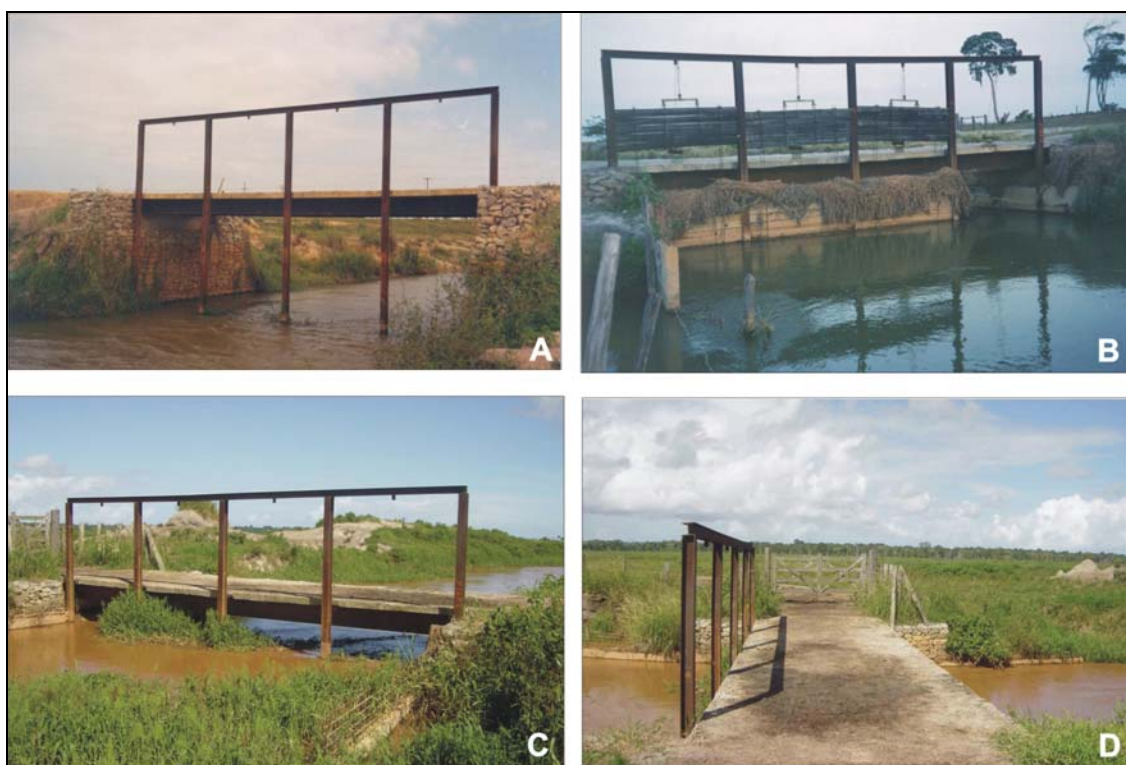
Figura 68. Aspecto geral das comportas ao longo do Canal Caboclo Bernardo. Veja Quadro 26.
