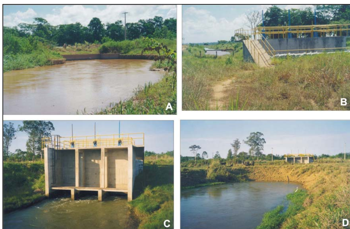
Figura 69. Início do canal, Fazenda Goianazes: primeira obra de seccionamento na estrutura do Canal Caboclo Bernardo em concreto armado com stop-logs (estruturas com finalidade de interromper, se necessário, o curso d'água). Veja Quadro 27 para maiores detalhes.
