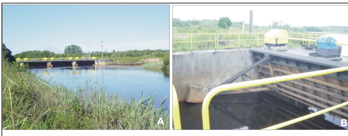
Figura 71. Comportas do rio Riacho: barragem móvel. Quadro 29.
