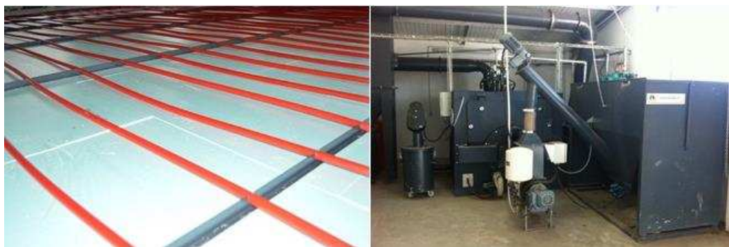
Figura 3. Vista da tubulação do sistema de aquecimento (durante o período de construção) e caldeira para aquecimento da água que percorre as tubulações no interior do aviário sólido, com isolamento térmico, para frangos de corte.
