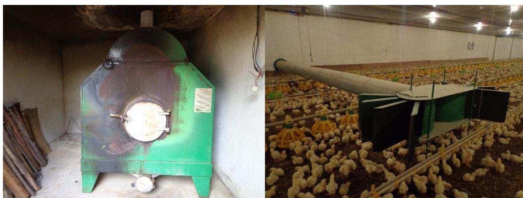
Figura 3. Sistema de aquecimento do ar do aviário sólido para frangos de corte.
