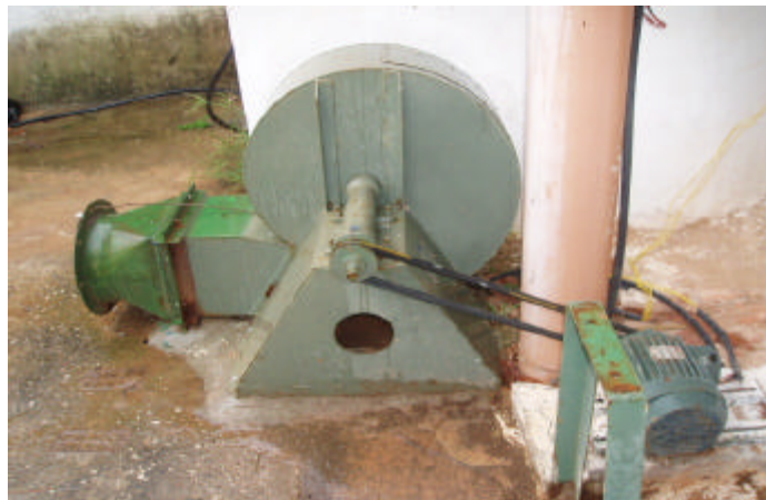
Figura 6 – Sistema de exaustão do ar aquecido.
