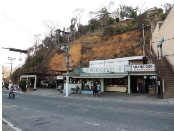
Figura 84. (a) Área-Piloto 04 - Vista Frontal do setor de risco com detalhe para os indícios de instabilidade da encosta (Setor 37 - R4)
