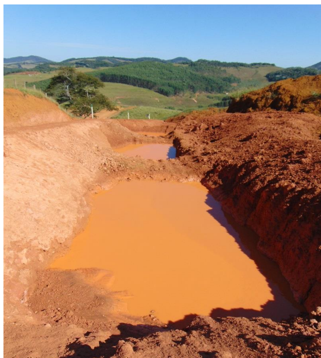
Figura 13 – Poços de decantação 1.3, 1.2 e 1.1 respectivamente em sequência, pertencentes a bateia de poços de decantação 1 da área de estudo, retendo o escoamento superficial proveniente da Mina.
