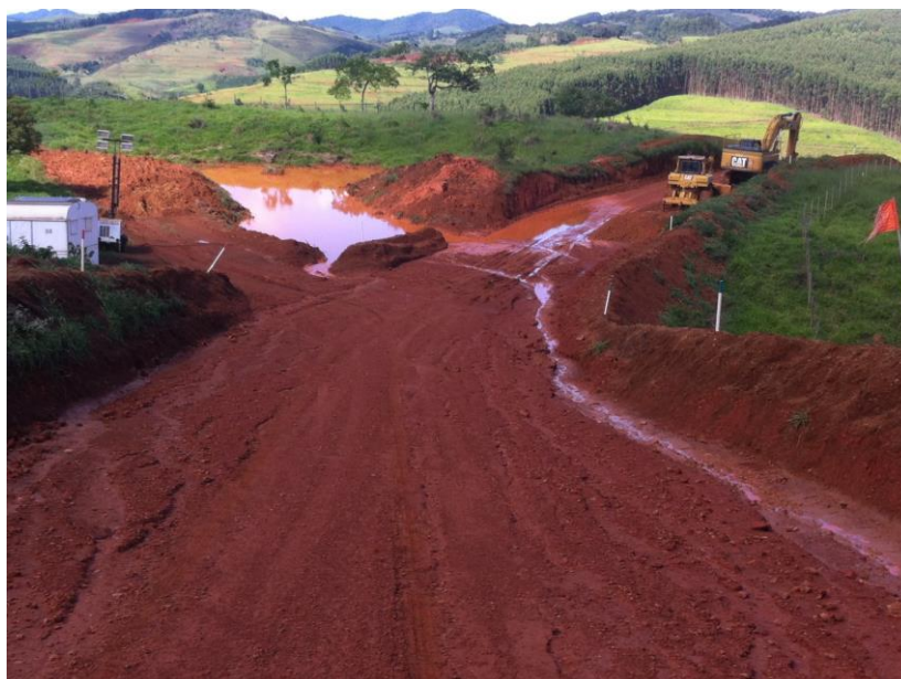
Figura 39 – Ponto de alagamento na estrada entre os sistemas 1 e 2 na área de mineração de bauxita em São Sebastião da Vargem Alegre, MG.
