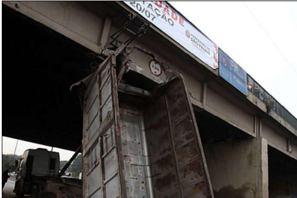
Figura 2.13 – Caminhão com caçamba levantada bate em ponte do Piqueri, na Marginal Tietê.
