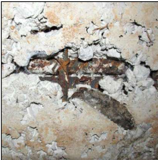
A - Armadura longitudinal positiva (25,0 mm de diâmetro) e estribos (10 mm de diâmetro) expostos (vista inferior da longarina)
