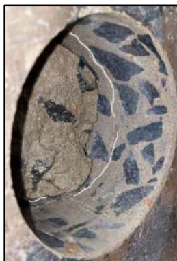
A - Fissura longitudinal na longarina
