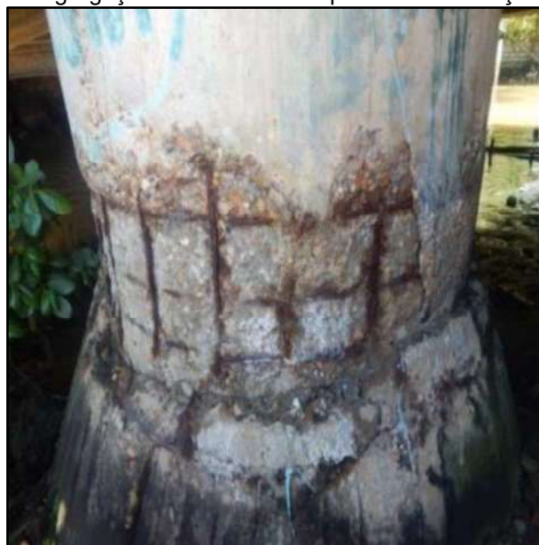
Figura 2.12 – Desagregação do concreto em pilar de sustentação de uma ponte.
