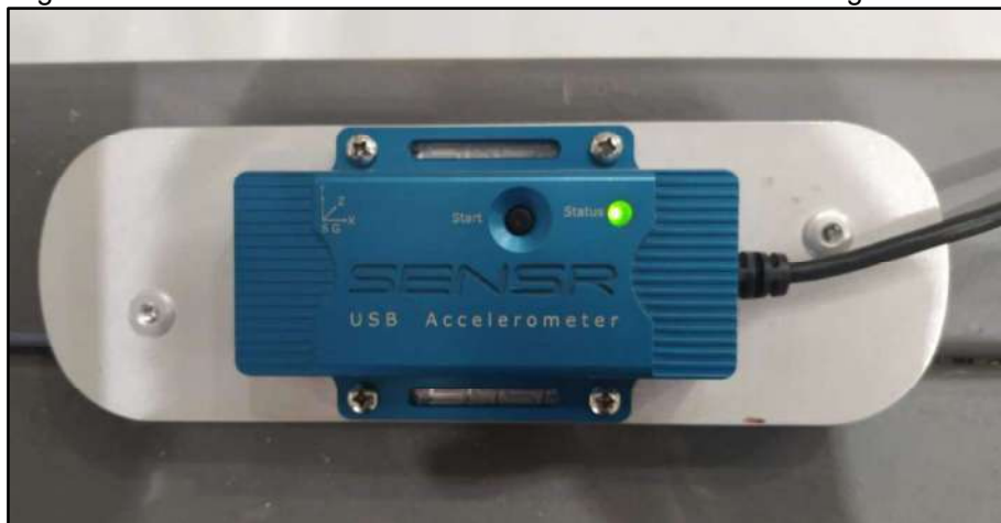
Figura 2.22 – Acelerômetro do modelo Sensr GP1L fixado em viga metálica.
