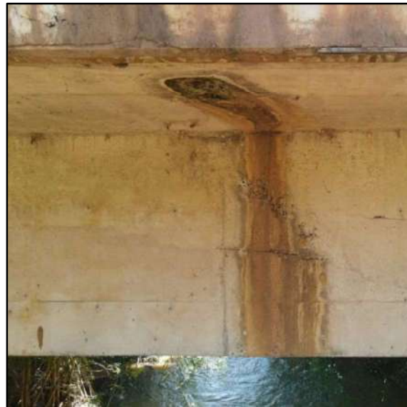
B - Deficiência da tubulação do dreno
