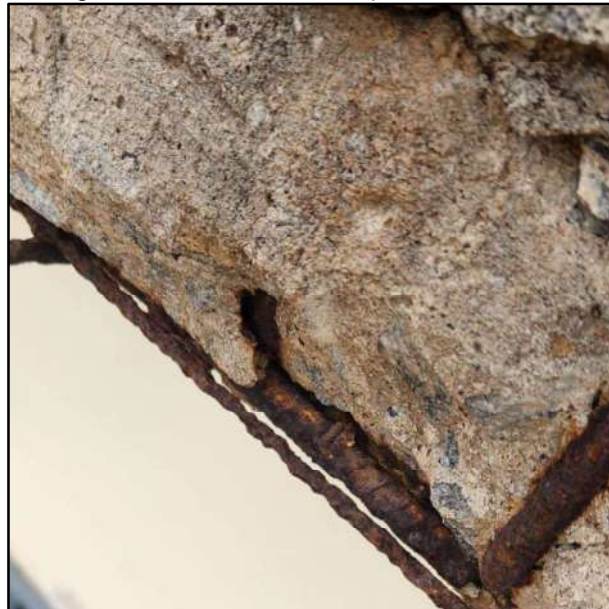
Figura 2.10 – Armadura exposta e corroída.
