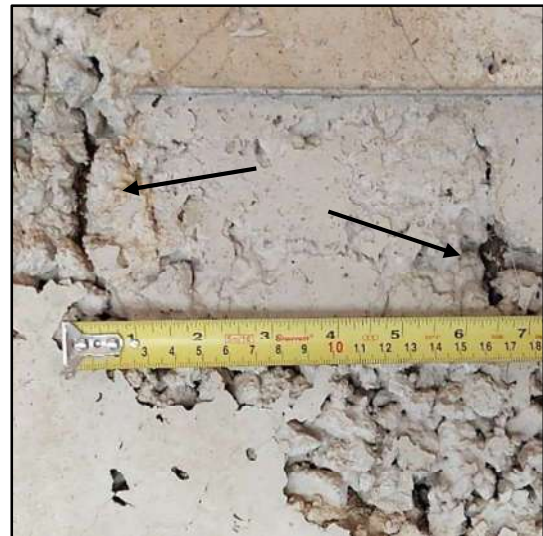
B - Estribos expostos
