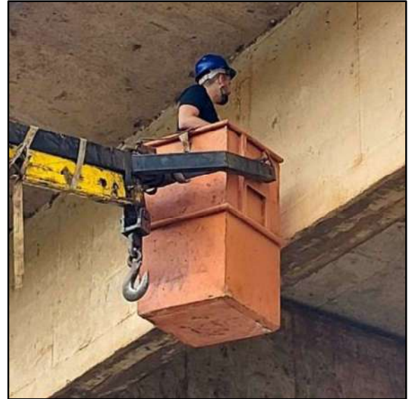
B - Avaliação das fissuras na longarina
