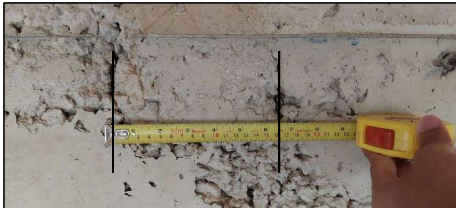
Figura 0.18 – Estribos expostos, próximos ao ponto 2.
