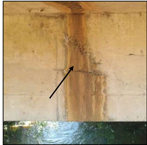
B - Bicheira no lado externo da longarina expondo o interior da estrutura à água que escorre devido à ausência de pingadeiras nos drenos (foto obtida apenas com auxílio do drone)
