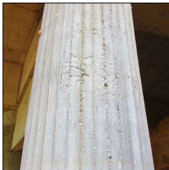
B - Bicheira de concretagem no pilar
