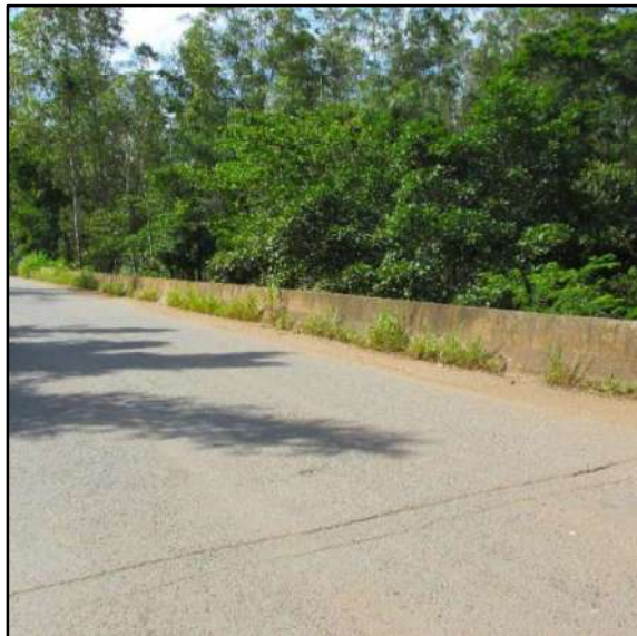
A - Obstrução do sistema de drenagem
