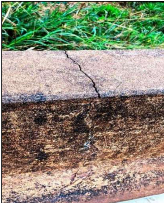
Figura 0.15 – Fissura na defesa.
