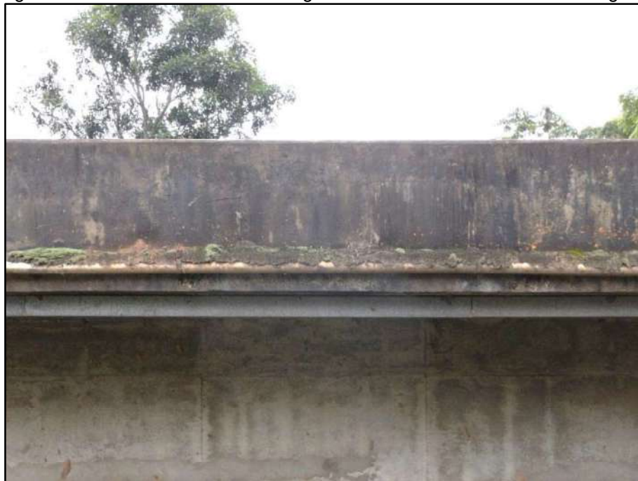
Figura 0.16 – Acúmulo de matéria orgânica na calha do sistema de drenagem.
