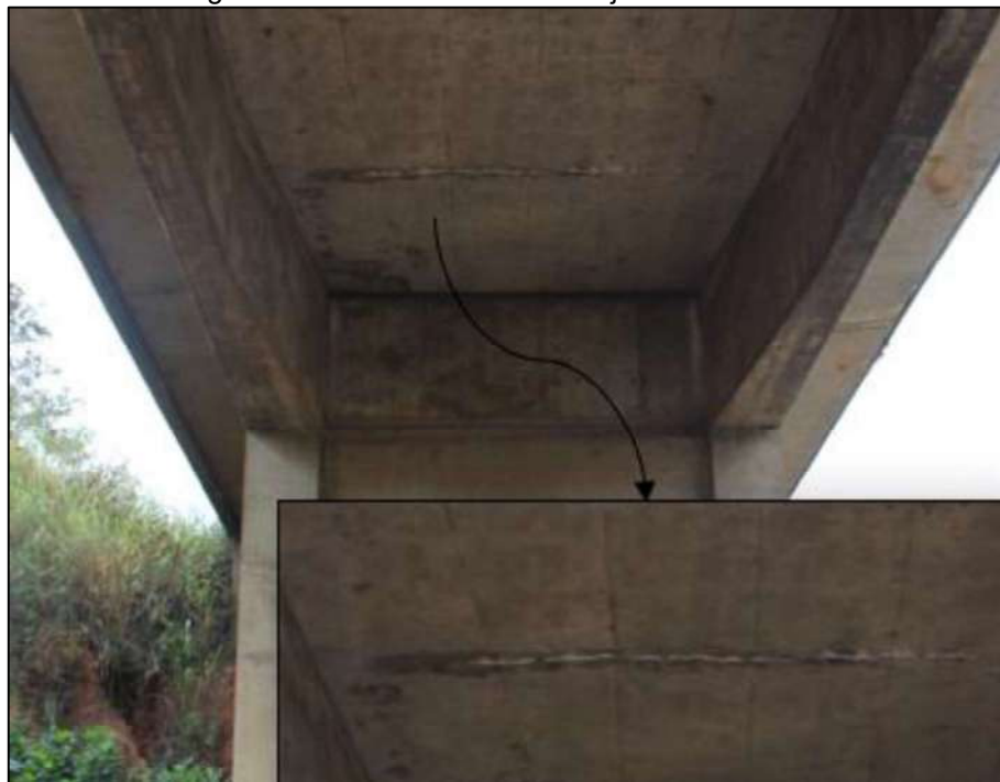
Figura 2.11 – Eflorescência na laje de um viaduto.
