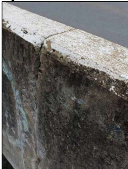
Figura 0.20 – Fissura na defesa.
