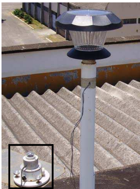
Figura 43- Piranômetro do tipo termopilha montado junto à célula fotovoltaica.
